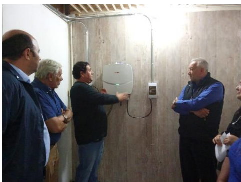
Estación de control de paneles solares
